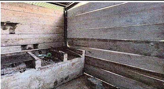
Foto 3: paredes deterioradas que necesitan ser rehabilitadas
