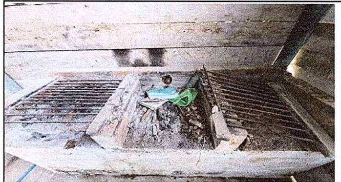
Foto 4: polleton en malas condiciones que necesita ser reparado
