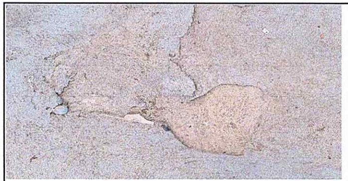
Foto 6: piso de cemento quebrado
