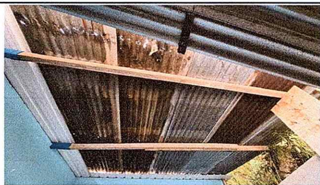
Foto 5: laminas y estrucutra de lamians en malas condiciones
