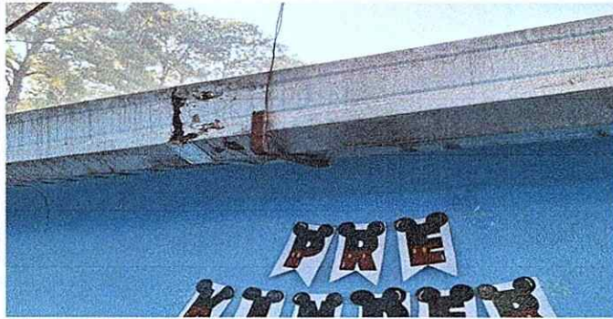
Foto 1: Canales en mal estado
